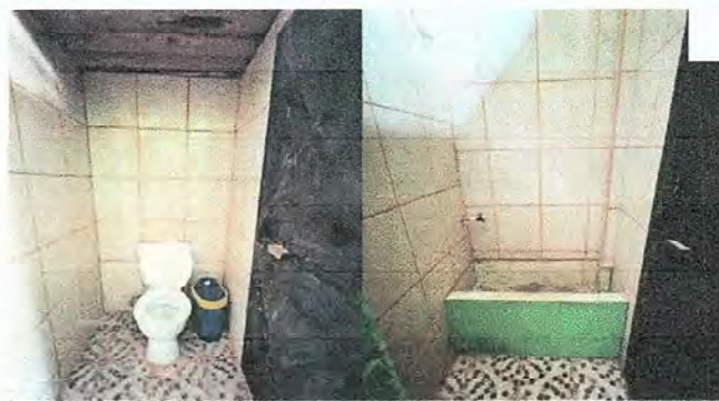
Foto 10: Sustrucción de azulejo, Módulo de Baños.
